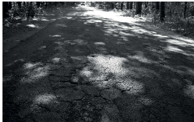
Nawierzchnia drogi pozostawia wiele do życzenia
