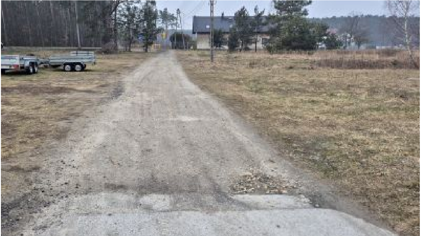
Ulica Opolska w Schodni przed remontem.
