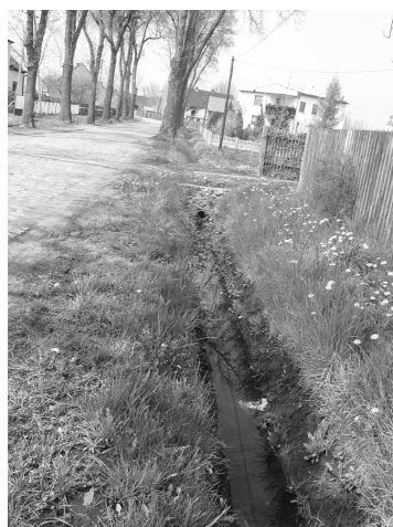
Zdj. 80. Rów melioracyjny również na ul. Cegielnianej nr 29.
